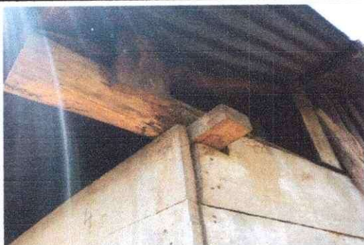
Foto 3: Sustitucion de vigas que estan picadas por el comejen
