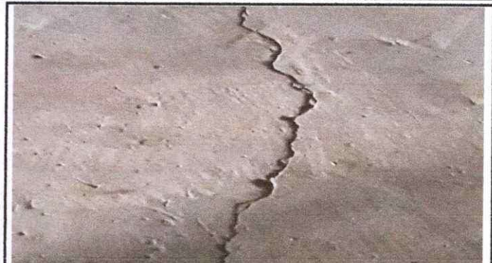
Foto 2: Emplazar torta de piso en el aula debido al poivazon la cual afecta la salud de los estudiantes.
