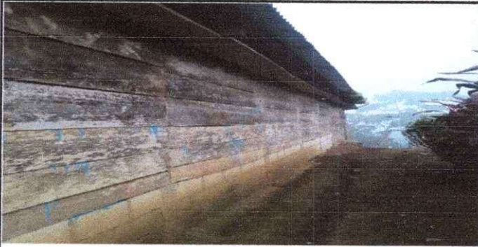
Foto 1: se observa la pared en falta de complementacion
